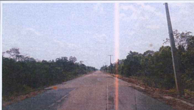
Na pista de rolamento se visualiza que foi executado o serviço de tapa buraco mas que tem acostamento precário
