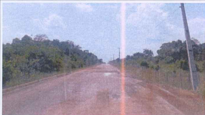
Presença de buracos na pista
