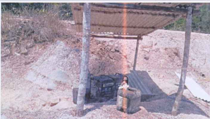
Pequeno gerador e vasilhame de combustível
