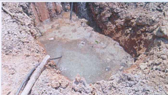
Poço que funciona como coletora de efluente líquido
